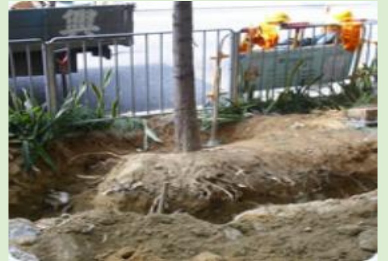
根部被嚴重切割或損害
